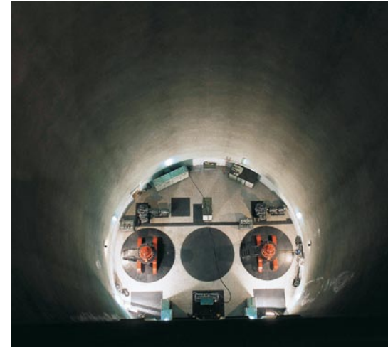
Pozzo sala macchine
